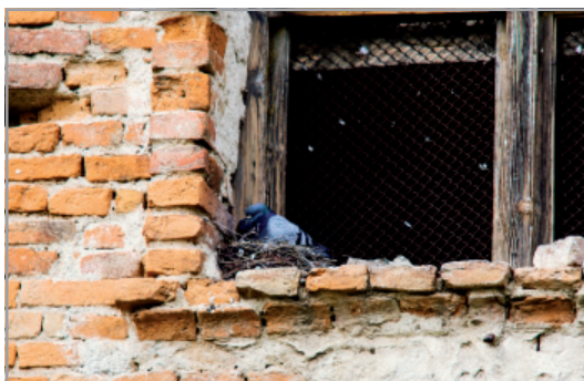
16. ábra: Az ózsinagóga épülete nincs megfelelően karbantartva, állapota folyamatosan romlik
